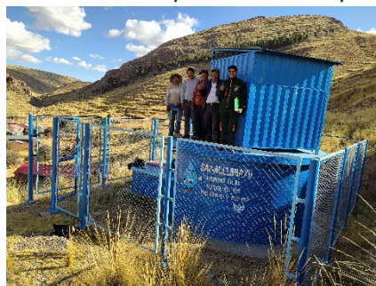
Protección de SAP y cloración del agua PMS Orurillo
